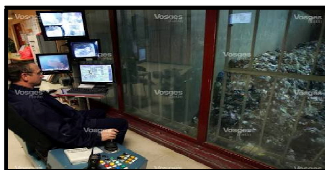
Figure III.5 : Poste de contrôle
