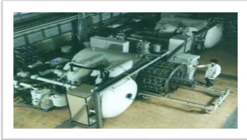
Figure.I.15. Groupe de pompage industriel en phase de chargement.
