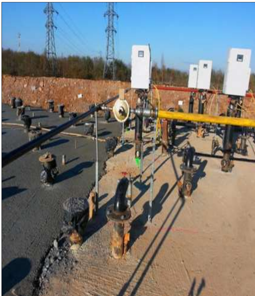
Figure 19- Désorption ( in-situ ) des brûleurs sur les sites contaminés pour effectuer une dépollution des sols (Valgo ,2021).
