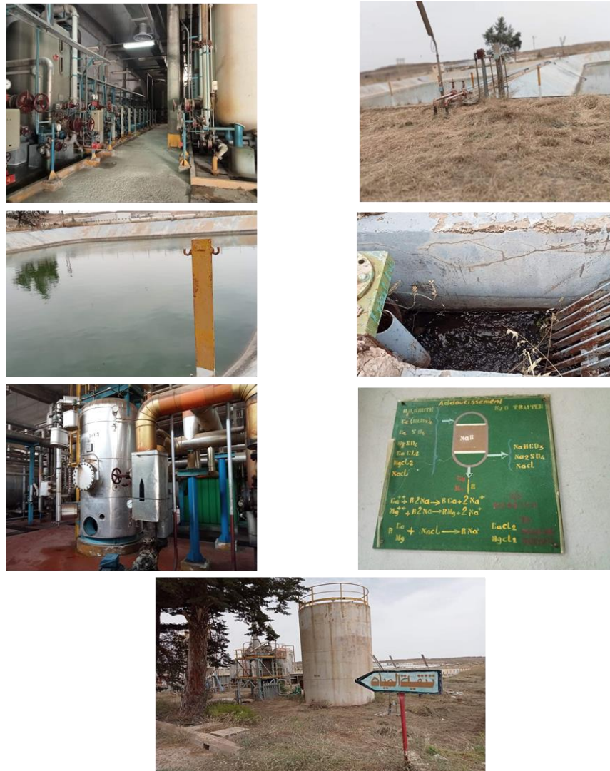
Figure 23: la station de traitement des eaux usées.
