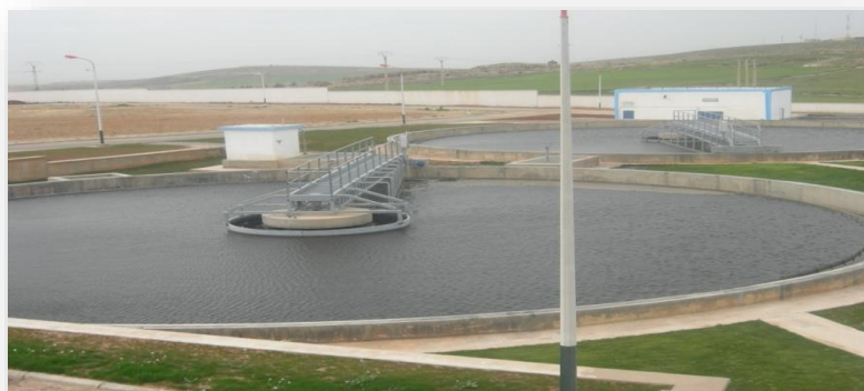
Figure n° 27: Le traitement physico-chimique (STEP Khenchela)
