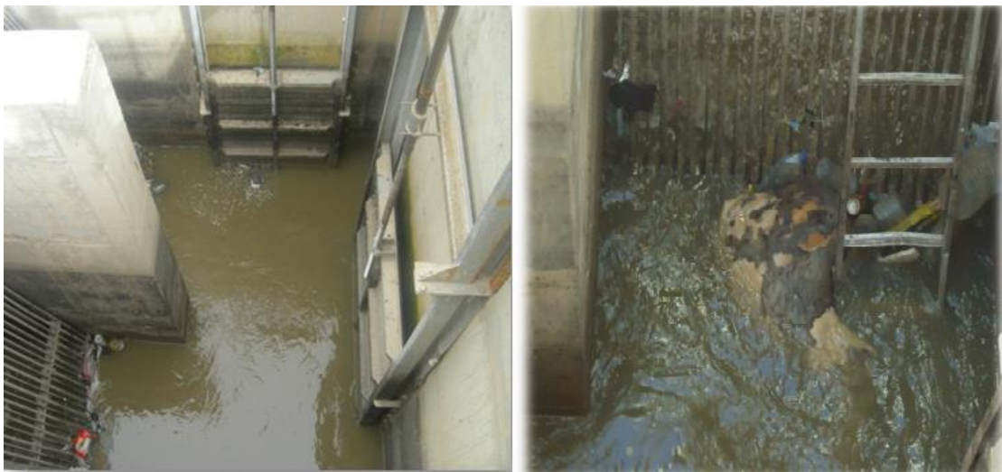
Figure n° 24 : Le dégrillage grossi (STEP Khenchela)
