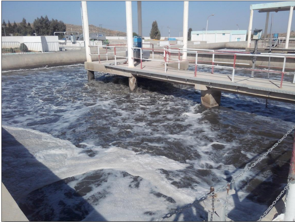
Fig.08 : Bassin d'aération au niveau de la station de Khenchela.
