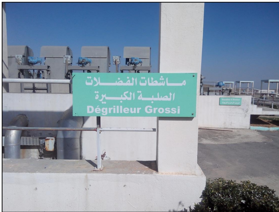
Fig.06 : Le dégrilleur grossier de la station de Khenchela.
