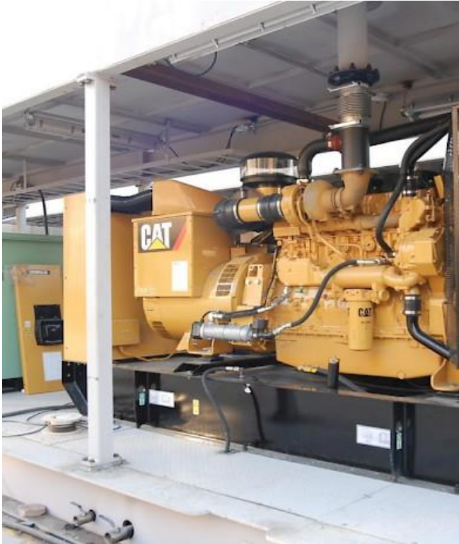
Figure 02: System de puissance (Caterpillar générateur) [A1]
