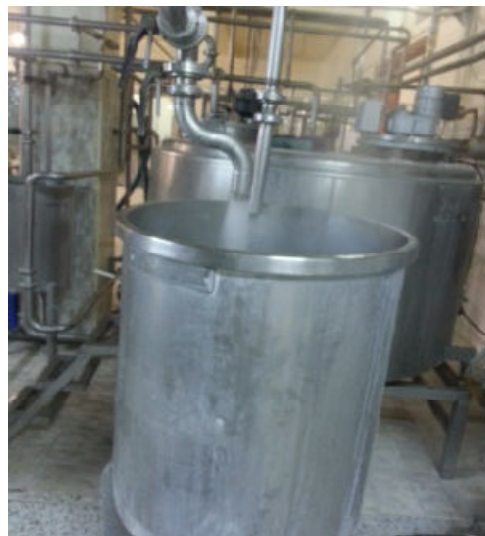
Photographie03: Traitement de l'eau.
