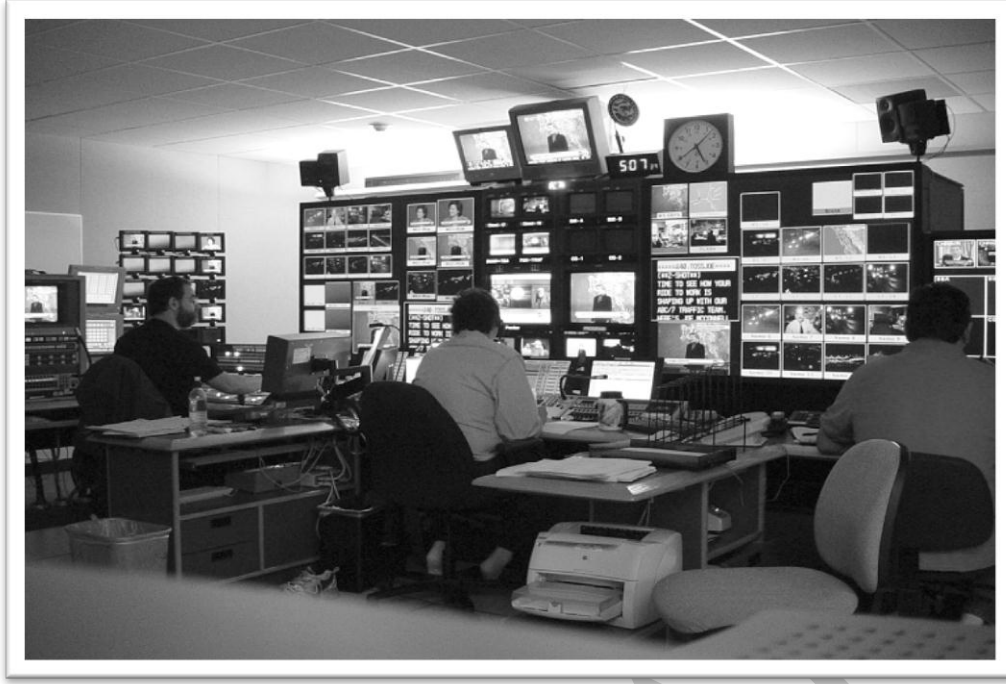
صورة رقم (13): توضح غرفة المراقبة في حالة نشاط*
