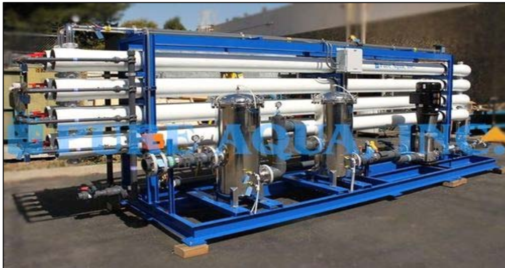
Figure V.5 : Exemple d'installation de Desulfatation
