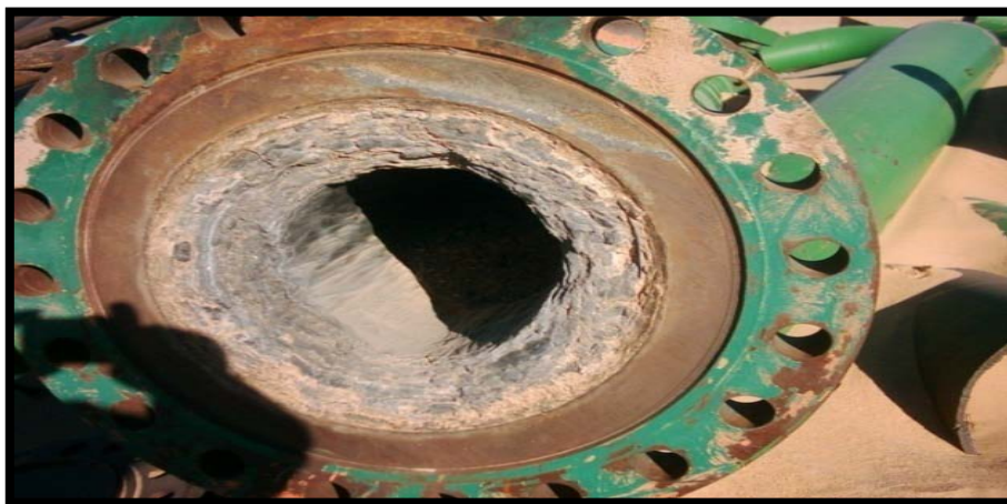
Figure III.7 : Dépôt de Sulfate de Baryum (BaSO 4 ) dans une conduite
