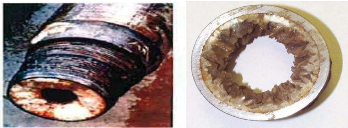
Figure IV.5 : Formation des dépôts à l'intérieur des conduites
