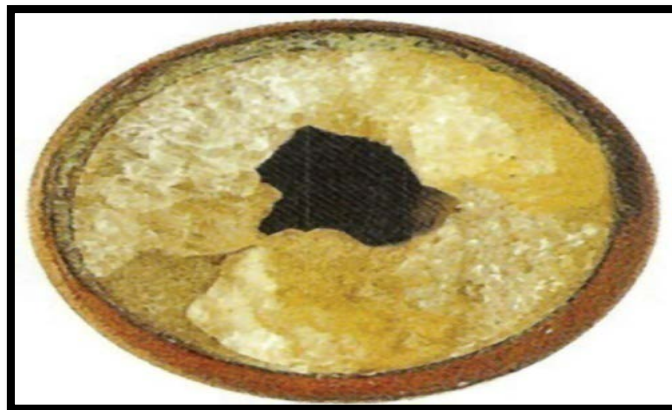
Figure III.3 : Dépôt de Chlorure de Sodium (NaCl) dans une conduite
