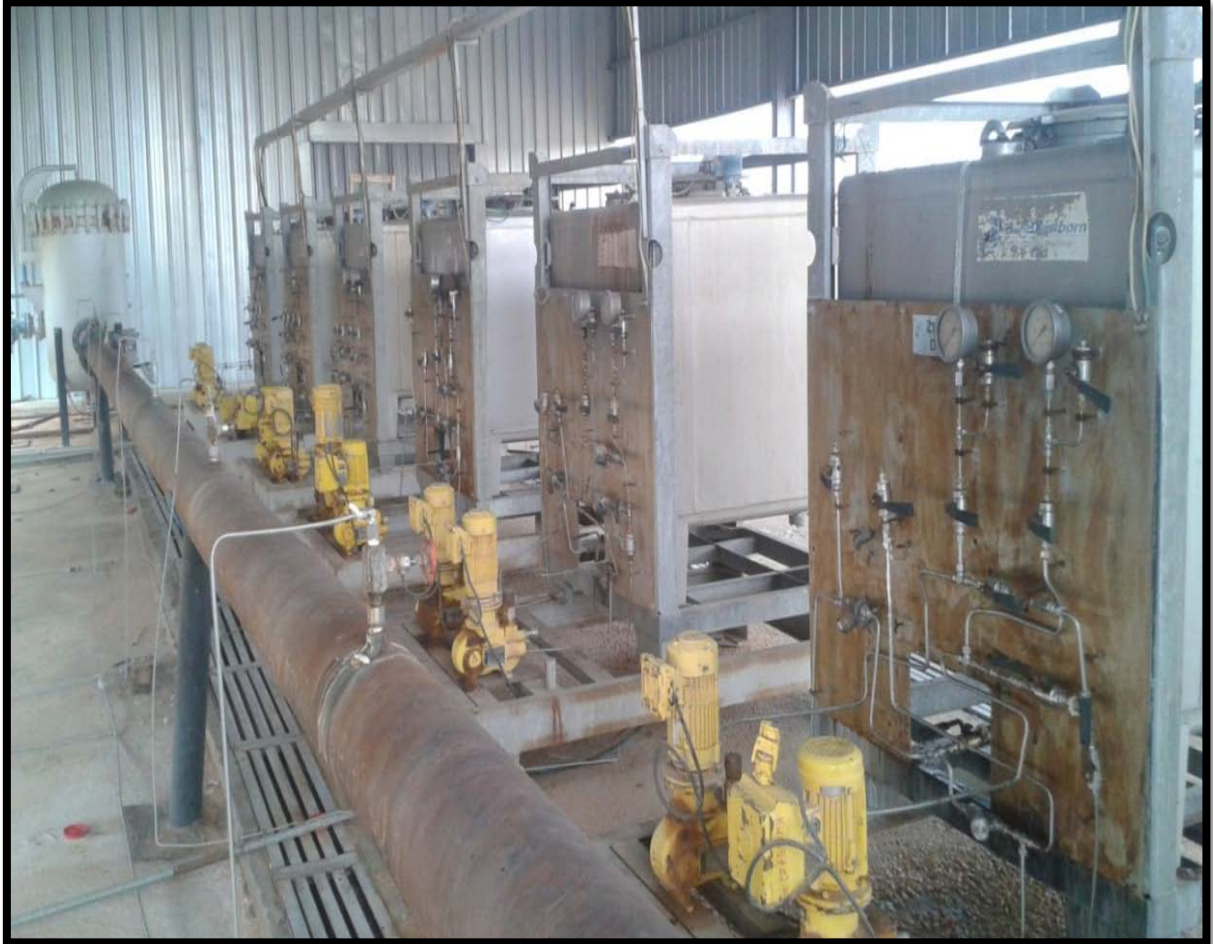
Figure IV.7 : Station de traitement existante au niveau du CINA
