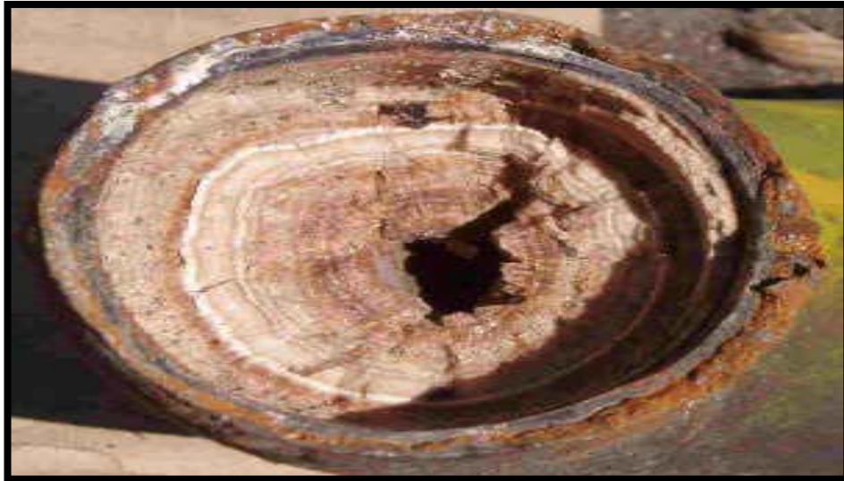
Figure III.4 : Dépôt de Carbonate de calcium ( \text{CaCO}_3 ) dans une conduite
