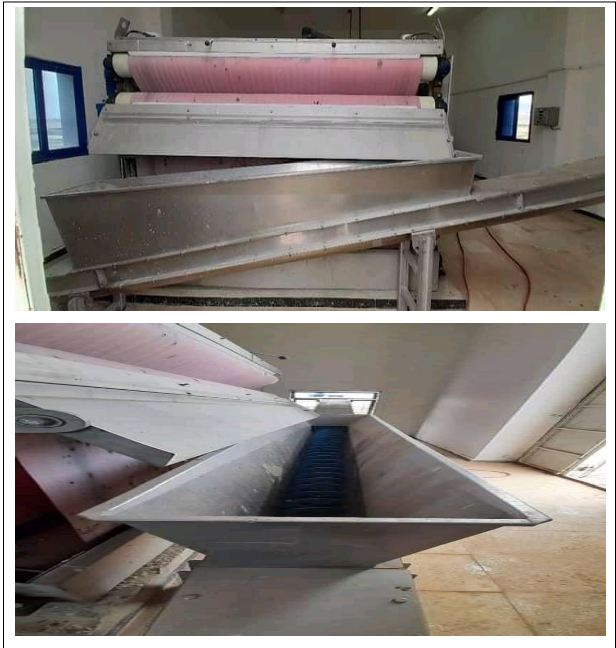
Figure 13 : Bloc de déshydratation des boues
