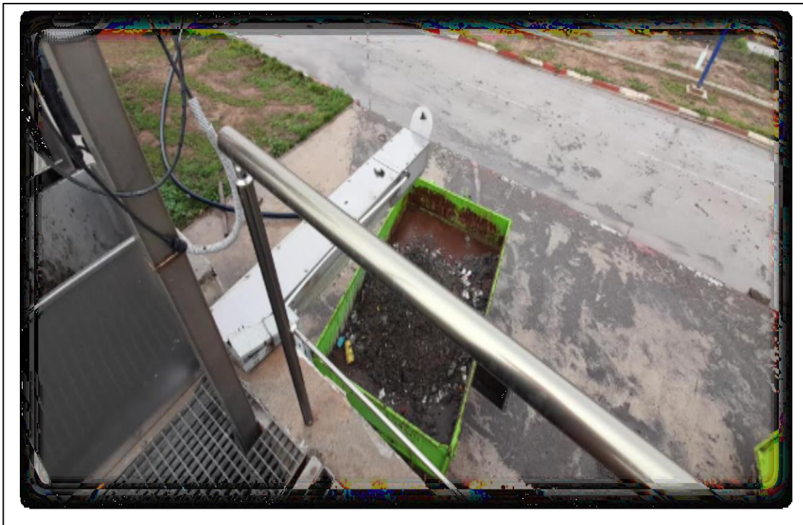
Figure 6 : Récupération des déchets de dégrillage fin dans une benne.
