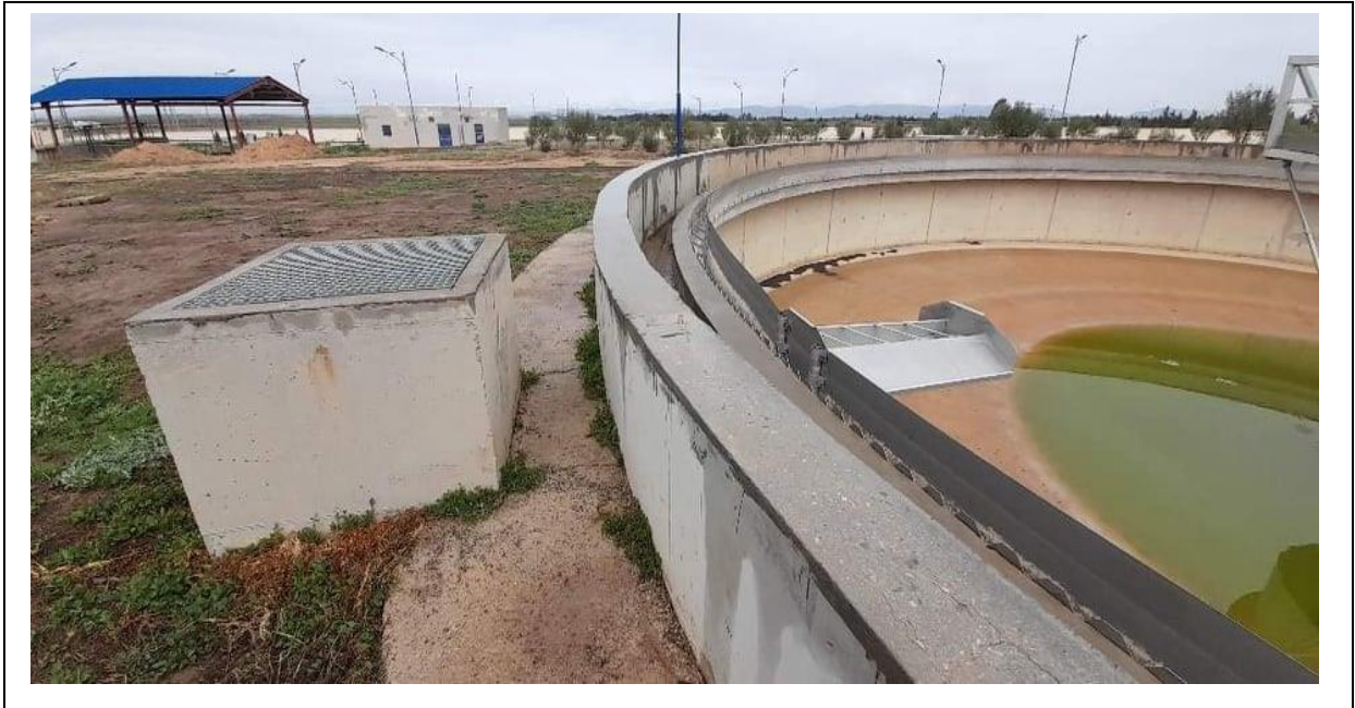
Figure 12: Epaisseur de la boue.
