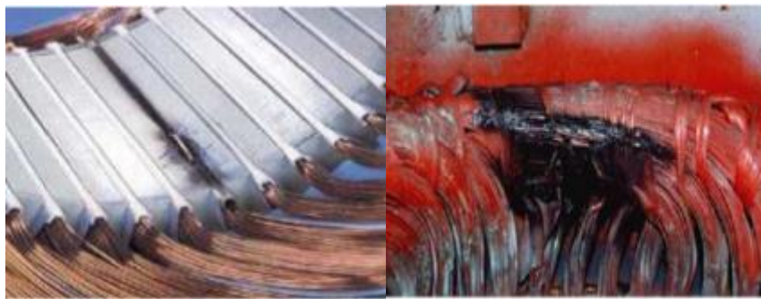
Figure I .12: Exemples de dégâts dus au défaut de court-circuit statorique d'un moteur asynchrone [NOU14].
