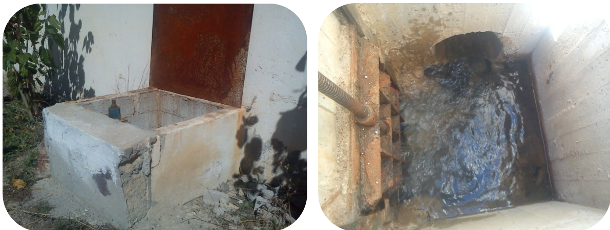
Photographie 03 : Collecteur principal de l'établissement hospitalier
