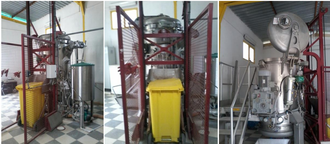
Figure12 : La machine de broyeur
