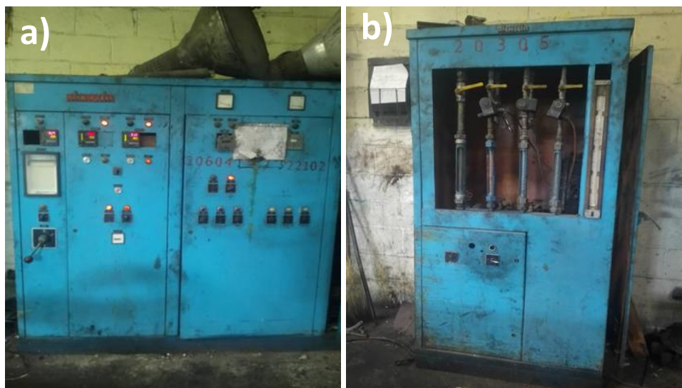
Figure II.18 : armoire de régulation thermique et panneau de régulation des gaz d'un four de cémentation.
