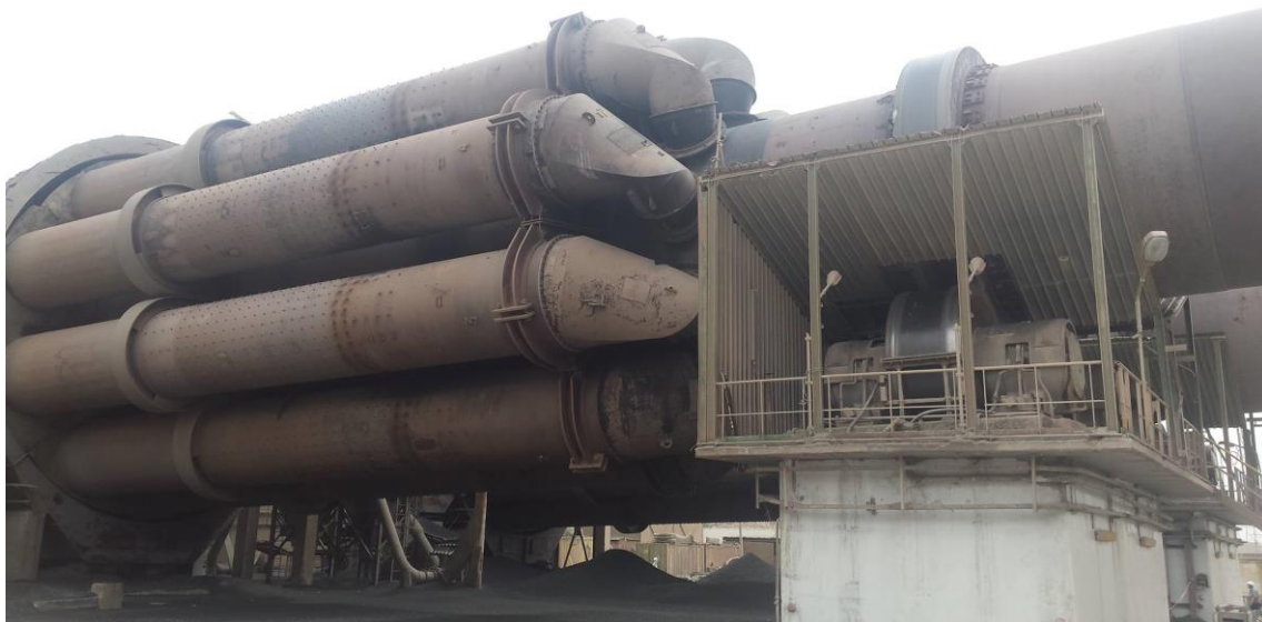
Figure II.9 : les ballonnets de refroidissement de clinker
