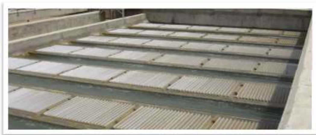
Figure 14 : bassin de décantation (MESSAOUDI et BOUZIDI., 2015).
