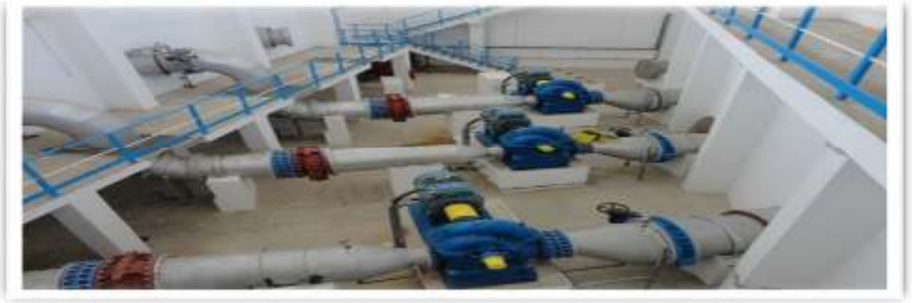
Figure 10 : station de pompage (MESSAOUDI et BOUZIDJI, 2015) (Fiche technique de Koudiet L'amadouer)
