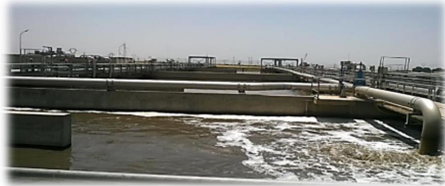
Figure III.12 : Le Bassin biologique.
