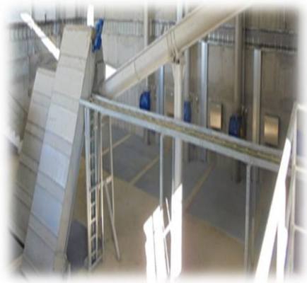
Figure III.6: Le Dégrillage grossier
