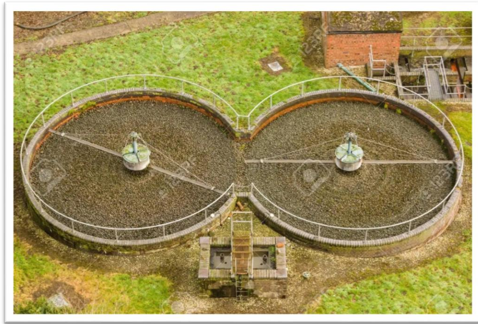
Figure II.9. Lits filtrants à lit bactérien d'épuration des eaux usées ou filtre biologique
