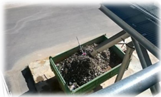
Figure III.9: La baine de déchets de dégrillage fin
