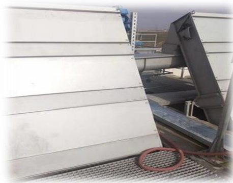
Figure III.8: Le Dégrillage fines.
