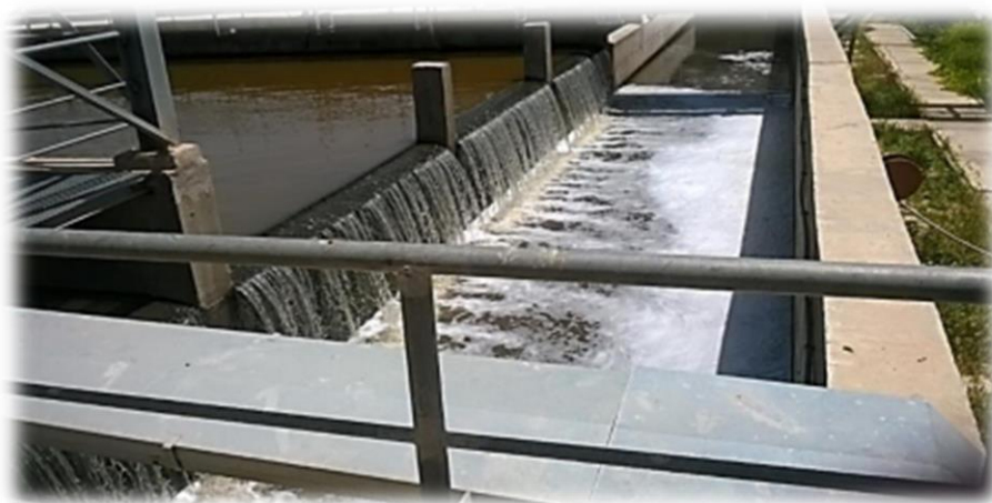
Figure III.13 : Le Bassin de dégazage
