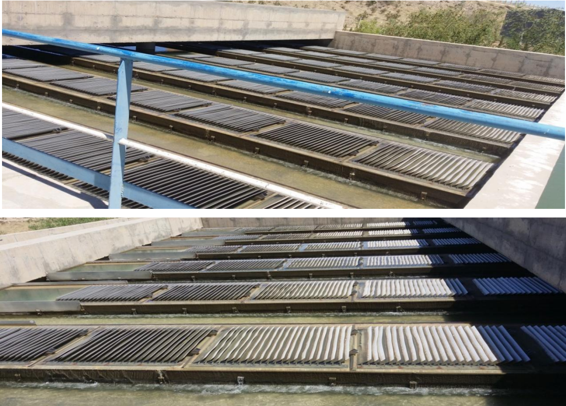
Photos 3.3. décantation lamellaire
