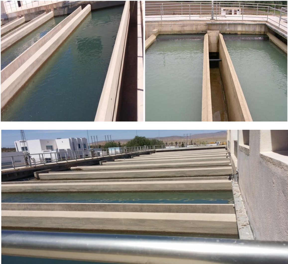
Photos3.4.cellule de filtration
