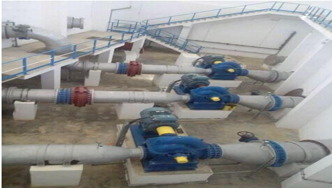
Photos 3.1. Point de pompage et station de relevage.
